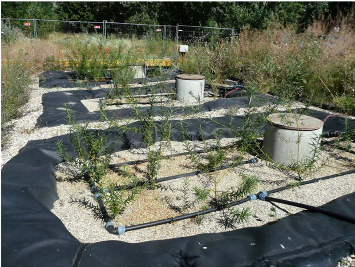
Abbildung: Pilotanlage: bepflanzten Bodenfilter mit Weidenbewuchs
