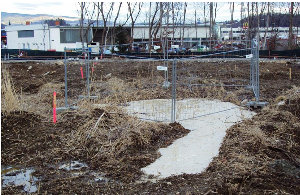
Abbildung 2: Im Zuge der Sanierung entdeckte ehemalige „Verfüllkünetten“ mit fast flüssigen Inhalten
